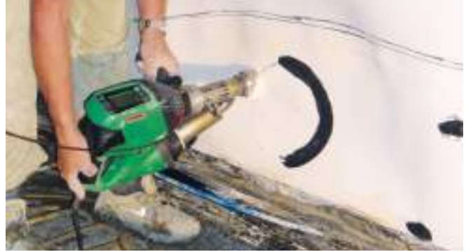
Удобный и надёжный ручной сварочный экструдер WELDPLAST S2 при работе в туннелях
